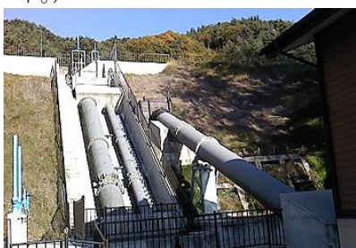
町川小水力発電施設。これ位の落差があれば発電可能。(右の1本が発電用。他は農業用水)
